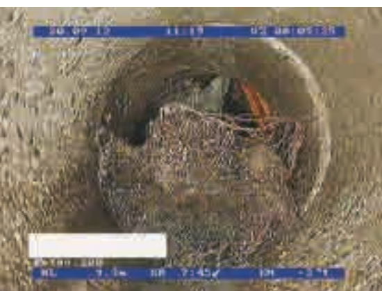
Wurzeleinwuchs in der Kanalisation
