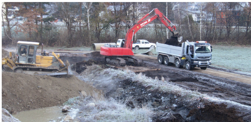
Die Torfaushubstellen werden direkt wieder mit Erdaushub verfüllt. Dazu ist der Einsatz mehrerer Maschinen notwendig.
