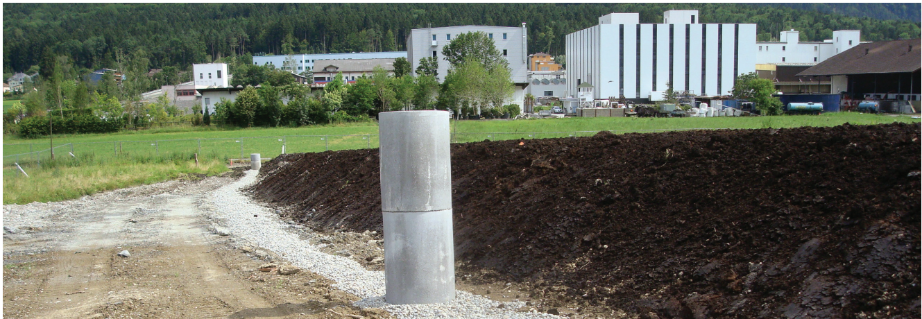
In regelmässigen Abständen werden Entwässerungsleitungen zur Unterstützung der Entwässerung der Rohplanie installiert.
