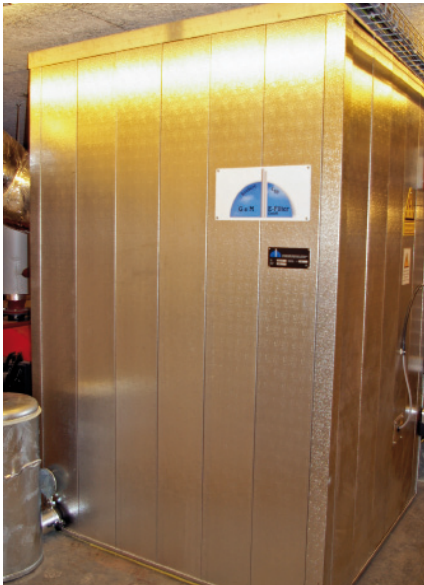
Feinstaubfilteranlage für die Hackschnitzelheizung im Mehrzweckgebäude Mauren-Schaanwald
