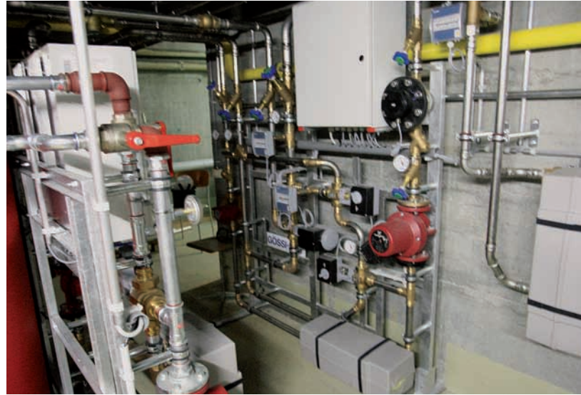
Neue Warmwasseraufbereitungs- und Lüftungsanlage
