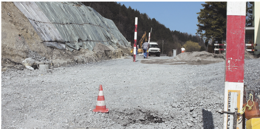
Der 2. Teil der 3. Bauetappe der Strasse «Auf Berg» ist in vollem Gange.
