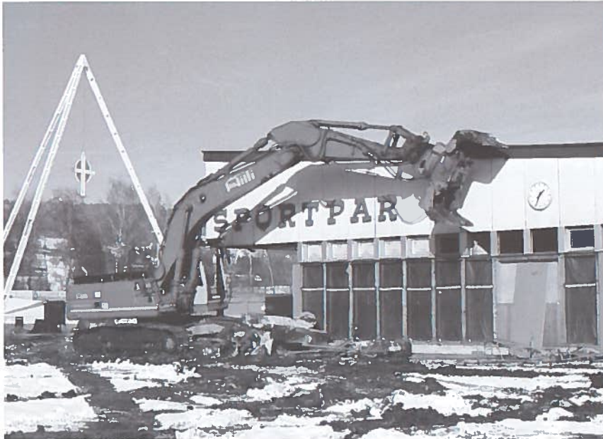
Unsere Aufnahme zeigt die Abrissarbeiten des Gebäudes im Sportpark Eschen/Mauren im Januar 2004.
