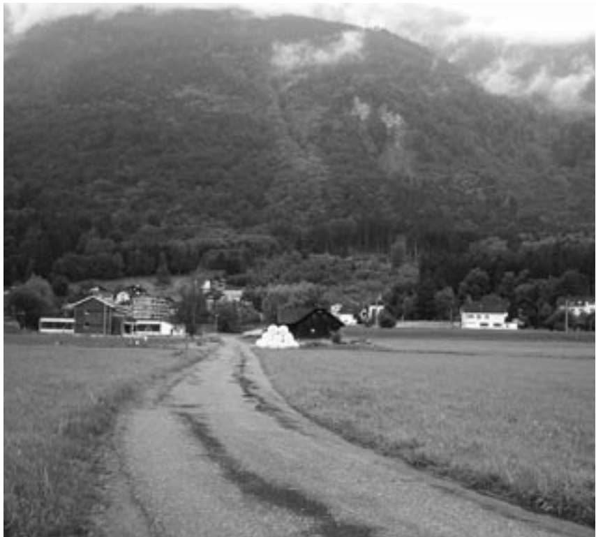
Die heutige Fahrbahn ist in einem sehr schlechten Zustand, so dass sich bei der Sägenstrasse dringend eine Fahrbahn-Sanierung aufdrängt.
