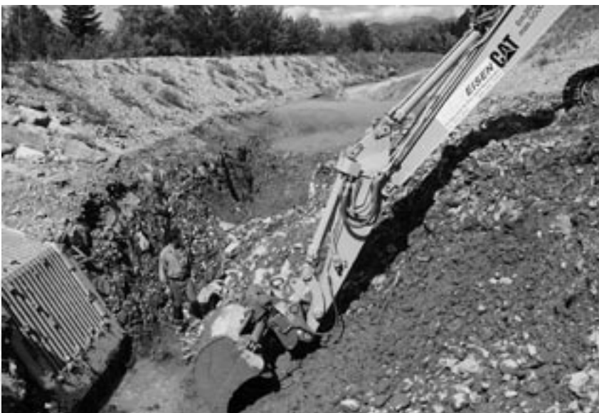
Hier sehen wir das Entleeren des Schutzdamms. Innerhalb von ca. 3 Tagen konnte die Mulde von ca. 2000 Kubikmeter Geröllmasse entleert werden.
