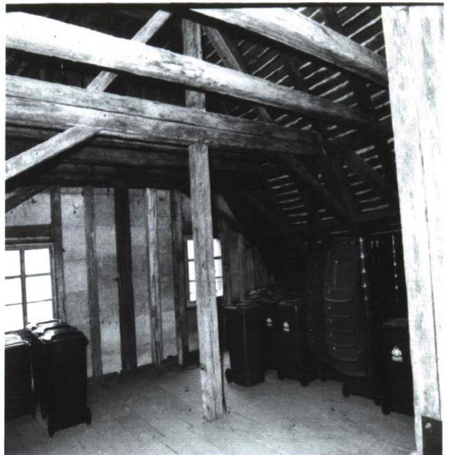
Auf dem Dachboden hat die heutige Besitzerin des Torkels, die Gemeinde Mauren, Müllcontainer untergebracht.
