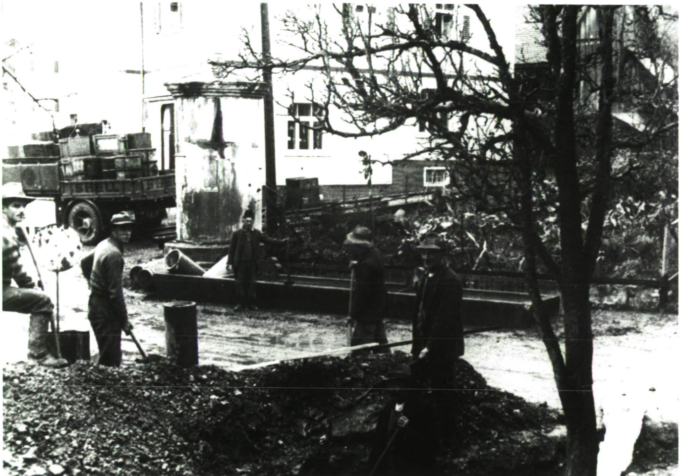
1932: Grabarbeiten für die Wasserleitung schräg gegenüber dem Kaufhaus-Café Matt. Auf dem Bild sehen wir von links Friedrich Marxer, Johann Wohlwend und Strassenmeister Georg Matt (ganz rechts). Im Hintergrund die Shell-Zapfsäule, die einzige Benzin-Tankstelle in Mauren. (Bilder: Egon Oehri)
