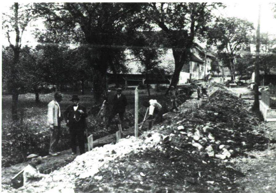
1932: Bau der Wasserleitung Richtung Dorf Mauren. Standort des Fotografen vis-a-vis Alois Ritter sen., Rapid-Maschinenhandlung. Stehend Zweiter von rechts (mit Hut) der damalige Vorsteher David Bühler.
