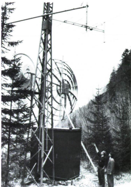
Hier die Kopfstation der GGA Mauren-Eschen beim «Hochwurz» am Maurerberg. Bruno Matt zeigt dem Gemeindevorsteher Johannes Kaiser die Anlage, über welche die Sender ARD, ZDF, Südwest 3, Österreich 1 und 2, SRG, TSI und SSR empfangen werden können.
